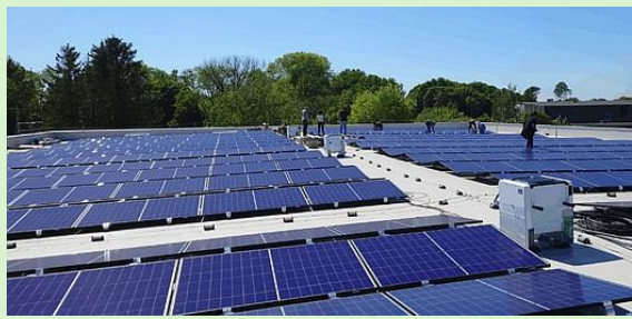
Abbildung 26: Foto der PV-Anlage "Quartiersgarage" mit PV-Modulen und Wechselrichtern (Quelle: Olegeno)
